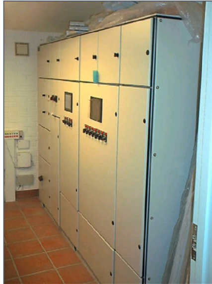
Komplet tavle: Tilgangs- og målerfelt, råvandstavle og rentvandstavle.
